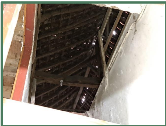
Er is geen dakbeschot aanwezig
