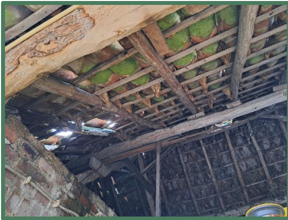
Ook hier is geen dakbeschot aanwezig
