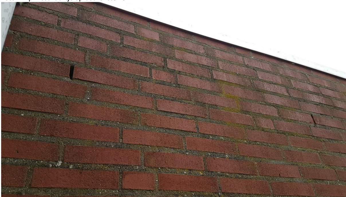
Foto 12: open stootvoegen naar de spouw op de noordelijke gevel.
