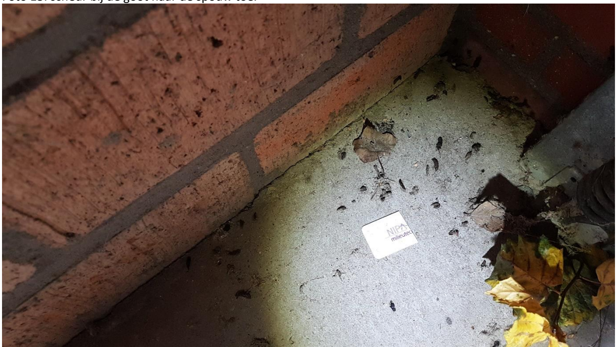
Foto 14: Keutels aangetroffen in de privéshuur, vermoedelijk van een vleermuis.
