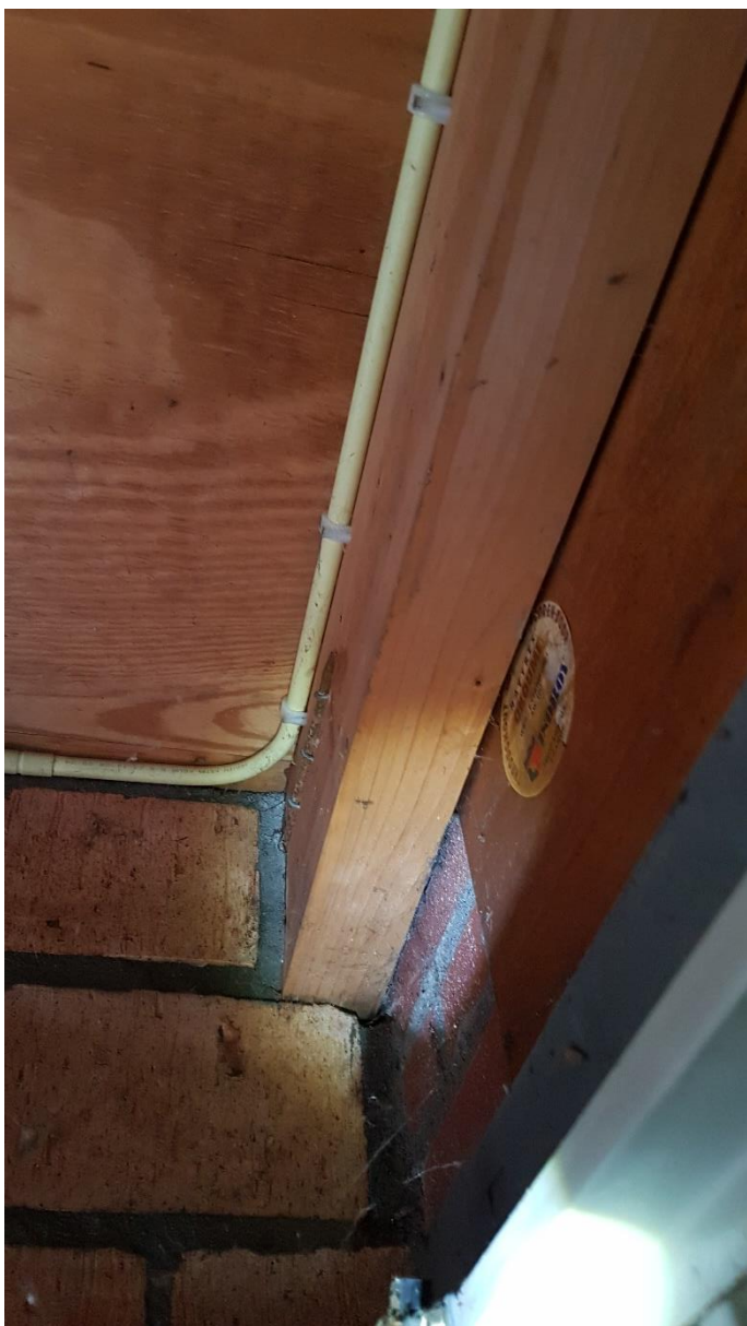
Foto22: opening van binnen naar de spouw, hieronder zijn keutels aangetroffen.
