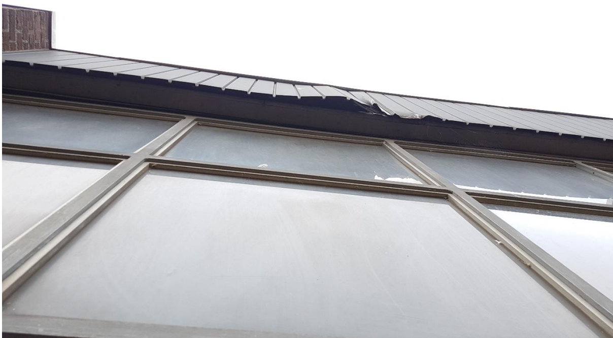
Foto 8: beschadigde beplating op de gevel.
