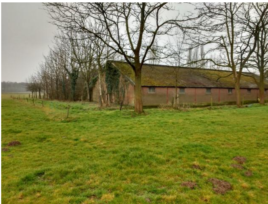
Foto 70: Kasteelweg 5 te Baexem (dak met asbesthoudende golfplaten)
