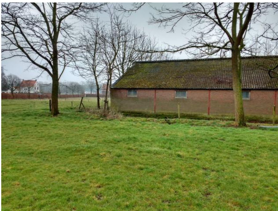
Foto 69: Kasteelweg 5 te Baexem (dak met asbesthoudende golfplaten)
