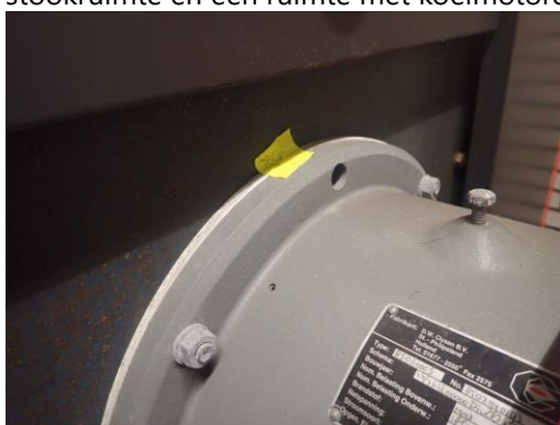
Foto 5: zie foto 4, ter controle de pakking ter plaatse van de aansluiting van de brander op de ketel bemonsterd als M4 (asbestvrij).
