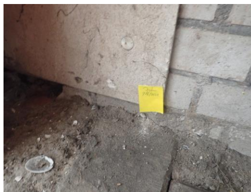
Foto 8: zie foto 7, brandwerend board langs de kolommen bemonsterd als M12 en als asbestvrij beoordeeld.
