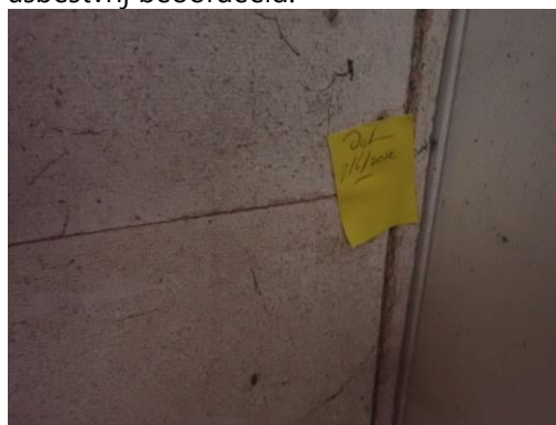
Foto 10: zie foto 9. Wandbetimmering van board bemonsterd als M13 en als asbestvrij beoordeeld.
