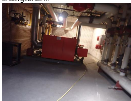
Foto 4: zie foto 3, de verwarmingsketels dateren uit 1993. Tegen het plafond rondom een koof van brandwerend board.
