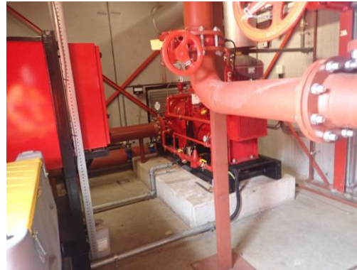
Foto 8: de flenzen en afsluiters in het leidingwerk zijn visueel geïnspecteerd den als niet asbestverdacht beoordeeld.
