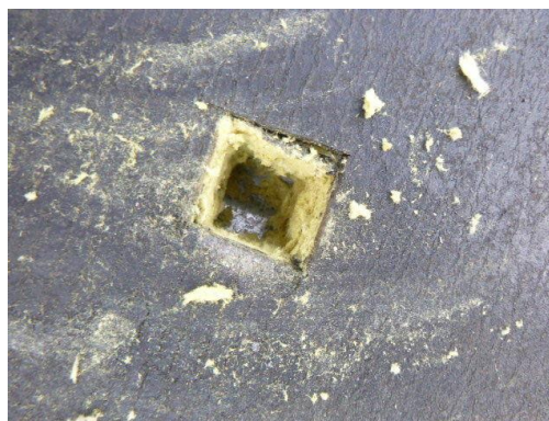
Foto 20: zie foto 19. De bitumen dakbedekking van het loadingdock bemonsterd als M20 en M21 en als asbestvrij beoordeeld.
