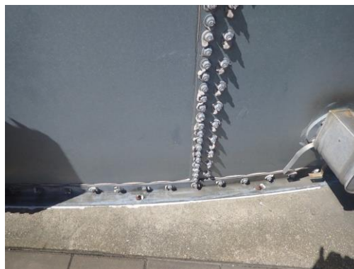
Foto 2: de bluswater voorraadtank waarvan de verschillende delen van de stalen wand met bouten aan elkaar zijn vastgezet (in de naden kit).
