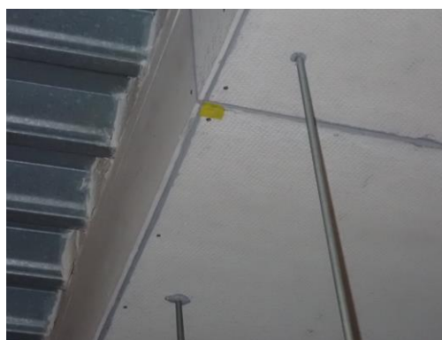
Foto 6: zie foto 4, de brandwerende betimmering van de koof bemonsterd als M3 en als asbestvrij beoordeeld.
