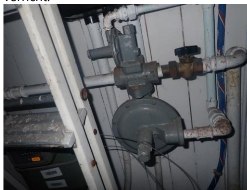
Foto 10: overzicht gaskleppen. Geen destructief onderzoek verricht.
