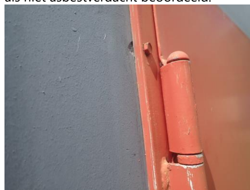
Foto 12: er zijn geen kitten als afdichting om het stalen deurkozijn toegepast.
