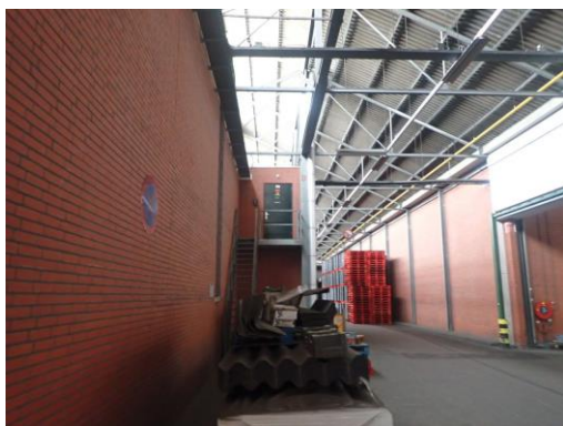
Foot 25: corridor naast sectie N. Technische ruimten met op de verdieping de brandmeldinstallatie en op de begane grond de niet toegankelijke hoog-/laagspanningsruimten.
