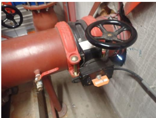
Foto 9: de flenzen en afsluiters in het leidingwerk zijn visueel geïnspecteerd den als niet asbestverdacht beoordeeld.
