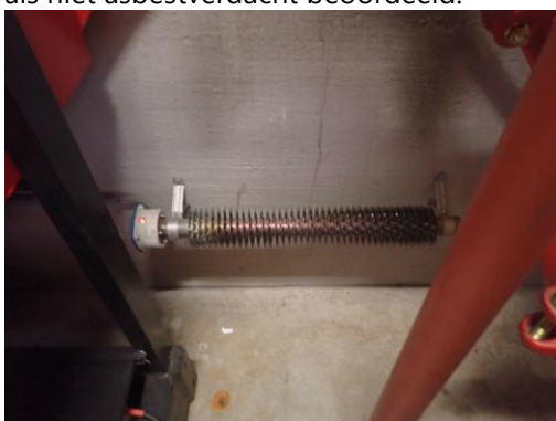
Foto 11: elektrische verwarmingselementen om de locatie vorstvrij te houden. Deze verwarmingselementen zijn dusdanig nieuw en worden als asbestvrij beoordeeld.
