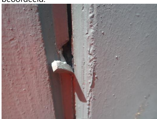
Foto 5: in de naden van de betonelementen niet asbestverdacht (nog zachte flexibele) kit met daarachter schuimrubber.
