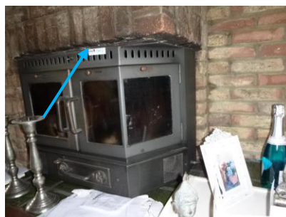
foto: afdichting (MM3)
