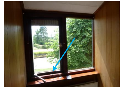
foto: afdichting (MM1)
