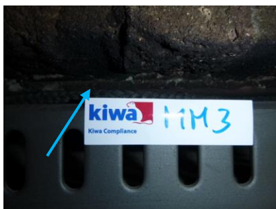
foto: afdichting (MM3)
