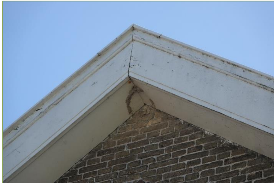
Restanten van een Huiszwaluwnest onder de houtbetimmering aan de gevel van de monumentale woning.
