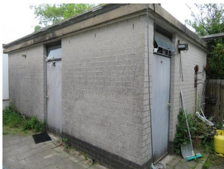
Afbeelding 14: de open stootvoegen in dit facilitair gebouw zijn te smal voor vleermuizen.
