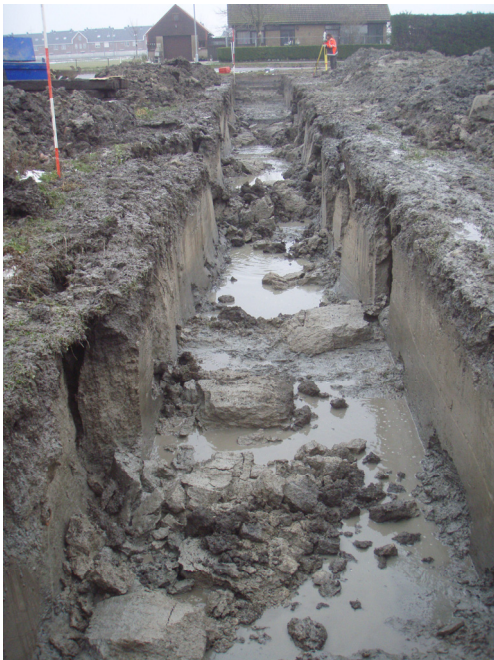
Afb. 3. Instortende putwanden in proefsleuf 2.
