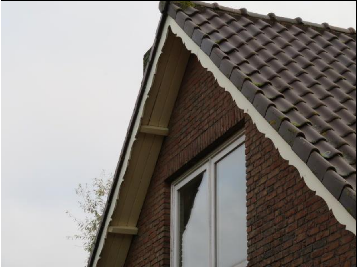
Foto 3: geen kieren tussen kantpannen en nokpan en overstek, geen kier tussen overstek en muur
