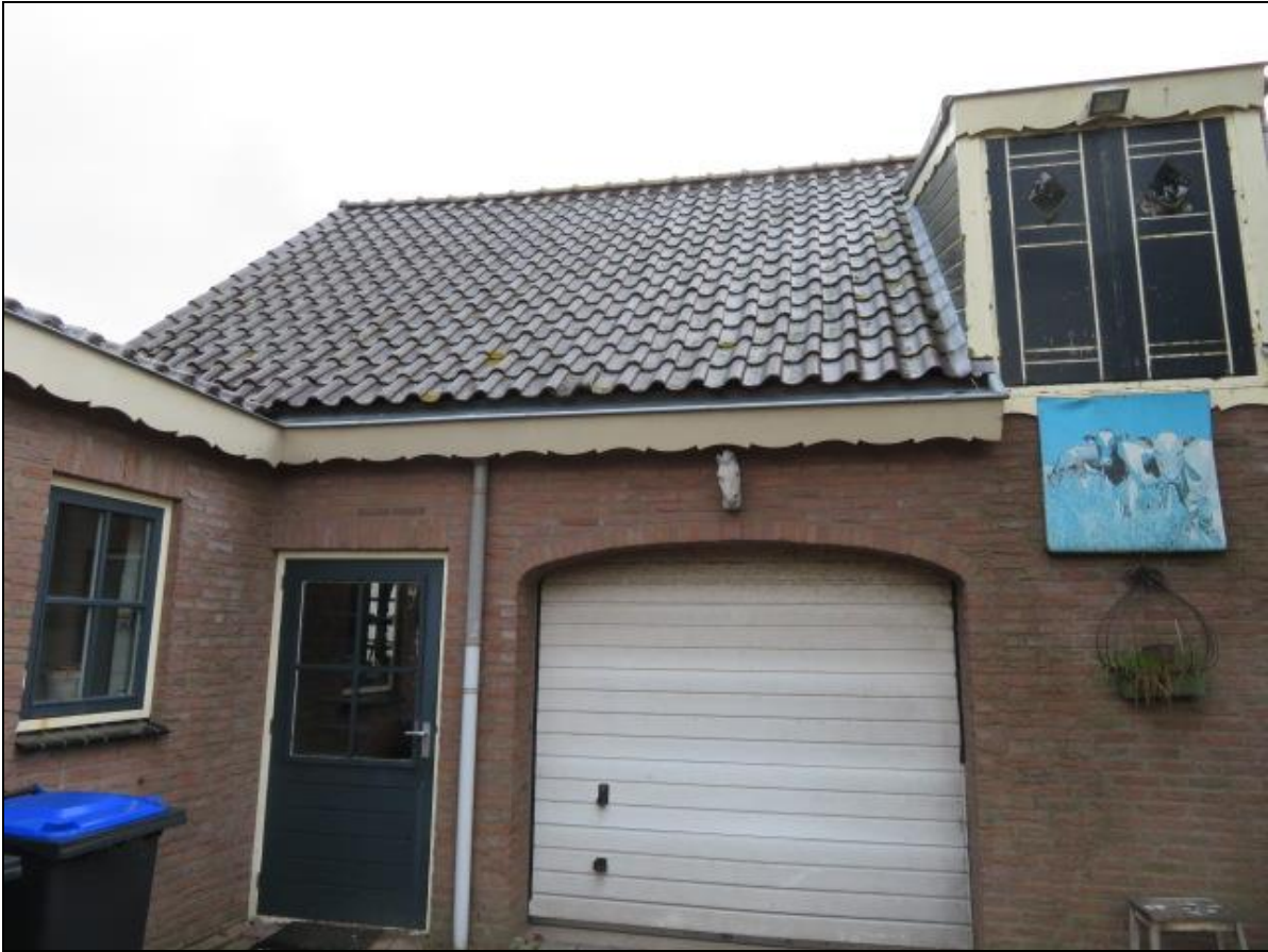
Foto 1: goed aansluitend pannendak met vogelschroot. Geen kieren bij loodslabben en dakkapellen.
