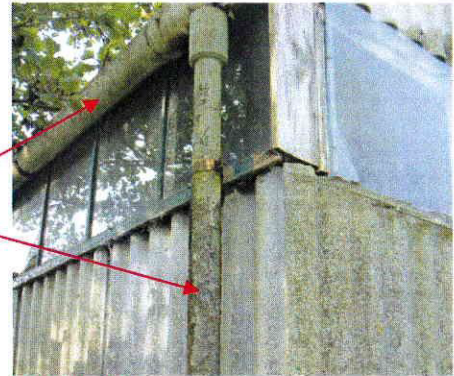
Foto 2: M1; Langs de dakrand en de gevels zijn asbesthoudende dakgoten en asbesthoudende hemelwaterafvoeren gemonteerd.
