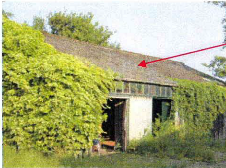
Foto 1: M1; De schuur is opgebouwd uit een houten constructie. Het dak is bedekt met asbesthoudende golfplaten . De gevels zijn bekleedt met asbesthoudende golfplaten .
