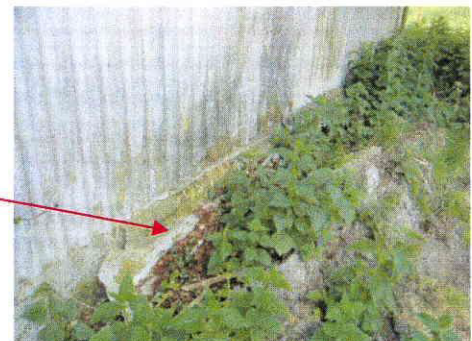
Foto 4: M1; Aan de buitenzijde van de schuur zijn op een aantal locaties restanten asbesthoudende golfplaten en asbesthoudende vormstukken aangetroffen.
