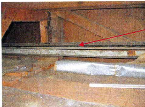
Foto 9: M3; Onder de werkbank in de werkplaats liggen twee houten gordingen met asbesthoudende kaskit .
