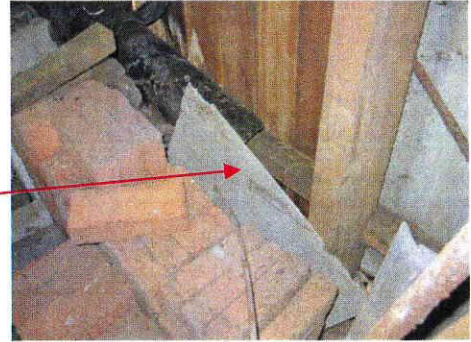
Foto 6: M2; In de schuur zijn op meerdere plaatsen restanten asbesthoudende vlakke platen aangetroffen.
