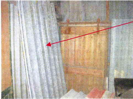
Foto 5: M1; In de schuur zijn op meerdere plaatsen hele, en restanten asbesthoudende golfplaten en vormstukken aangetroffen.
