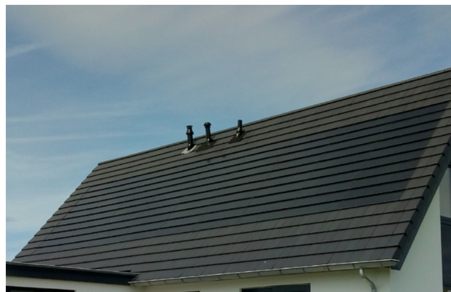
Afbeelding 20: Dakdeel met zonnepanelen
