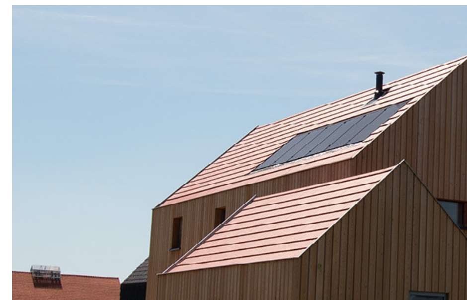
Afbeelding 21: Dakdeel met zonnepanelen
