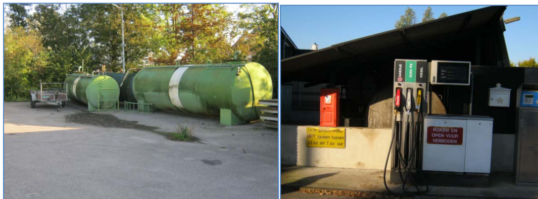
Figuur 5: Opslag mobiele brandstoftanks en brandstofinstallatie
