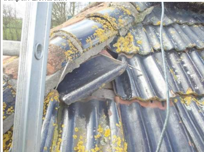
foto nr. 46 Een slordige reparatie zichtbaar. (= lekkage)
