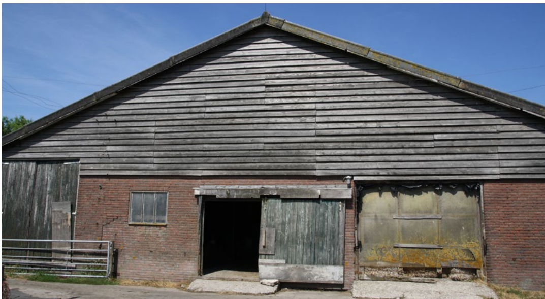
Stal ca 820 m2 met bakstenen gevel gecombineerd met hout, de stal is in vervallen staat van onderhoud.
