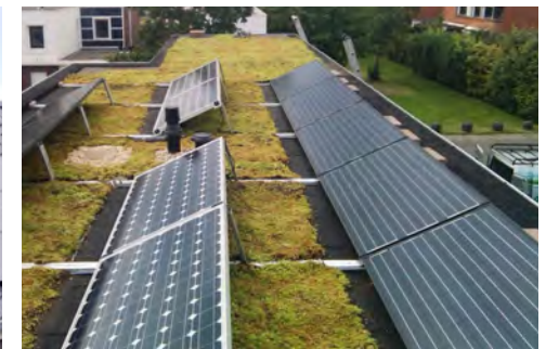
PV panelen groen dak
