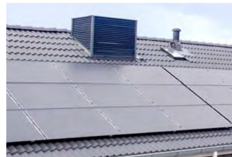
PV panelen en luchtwarmtepomp
