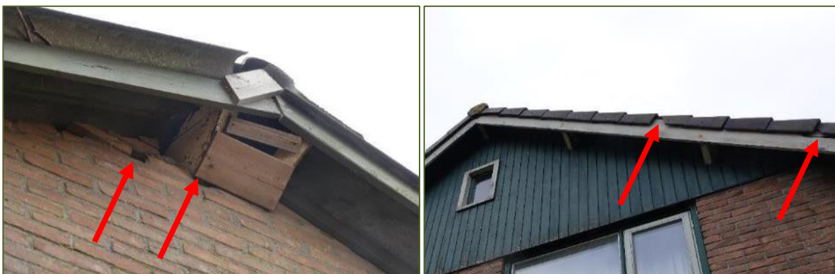
Verschillende gaten en spleten (rode pijlen) in de bebouwing geven mogelijk toegang tot voor vleermuis geschikte achterliggende holtes.
