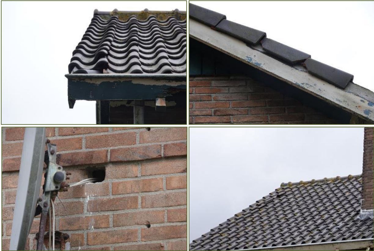
De openingen in de bebouwing geven mogelijk toegang tot voor Huismus of Gierzwaluw geschikte achterliggende ruimtes.
