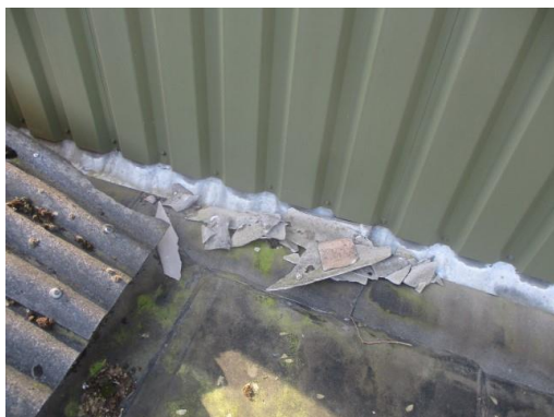
Losse stukjes golfplaat op dak tussen schuur 2 en 3
