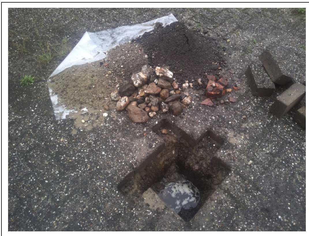
Foto 3. Asbestgat en opgegraven materiaal ASB-01
