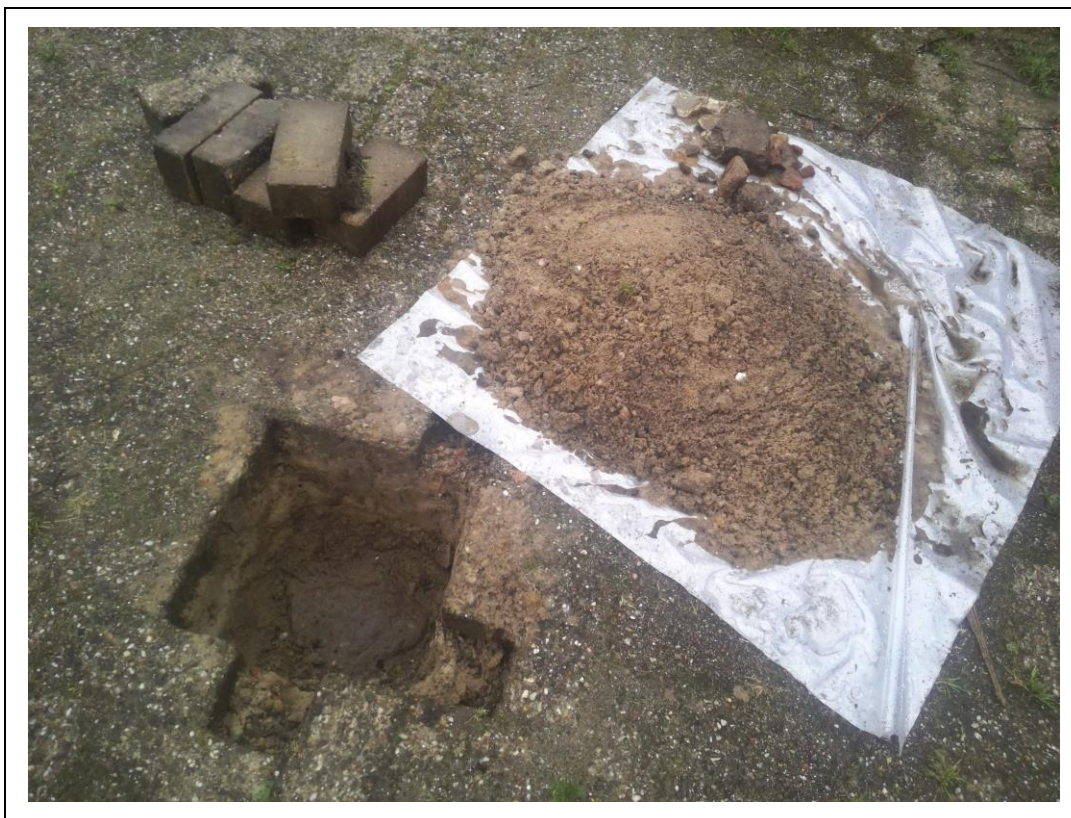
Foto 9. Asbestgat en opgegraven materiaal ASB-07
