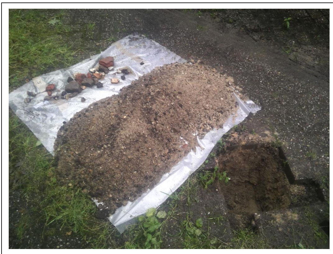
Foto 6. Asbestgat en opgegraven materiaal ASB-04
