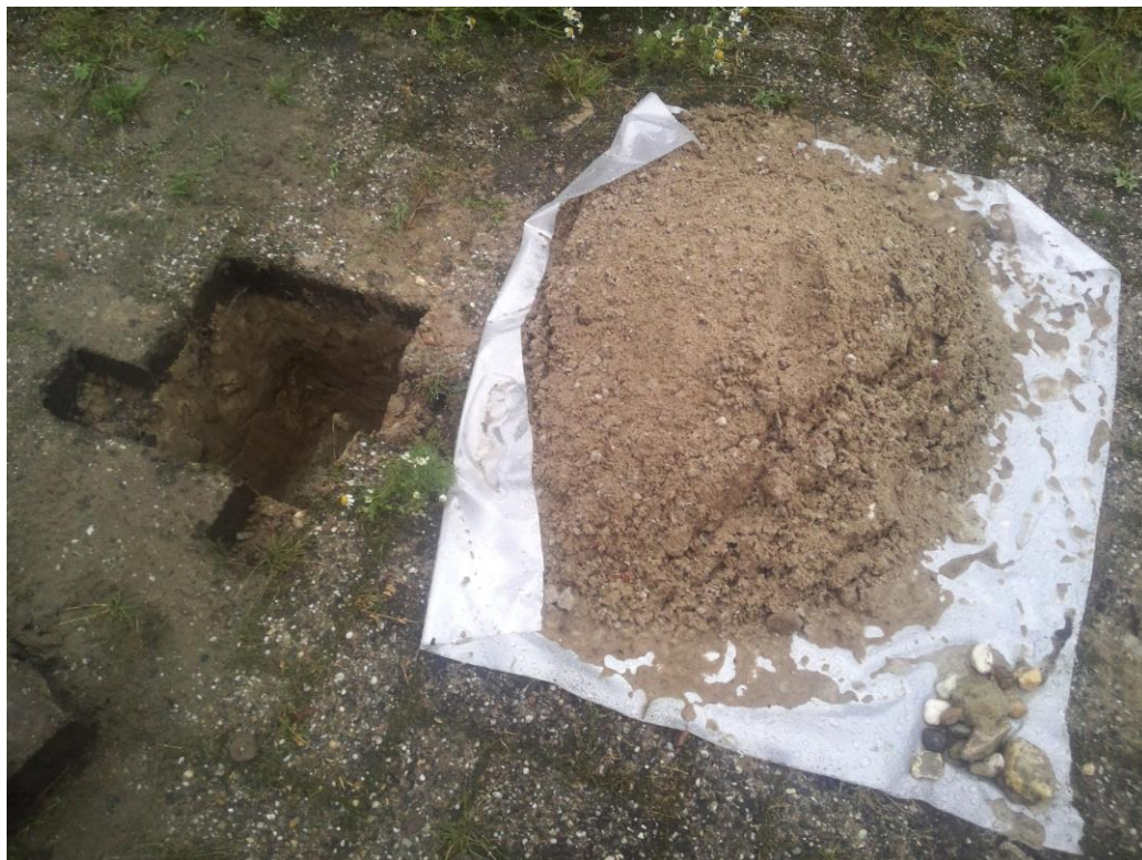
Foto 11. Asbestgat en opgegraven materiaal ASB-09
