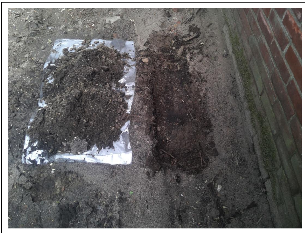
Foto 1. Asbestsleuf en opgegraven materiaal B01 (druppelzone)
