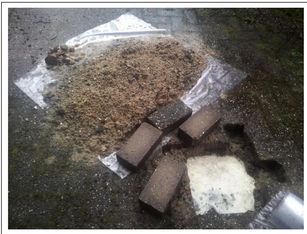
Foto 7. Asbestgat en opgegraven materiaal ASB-05
