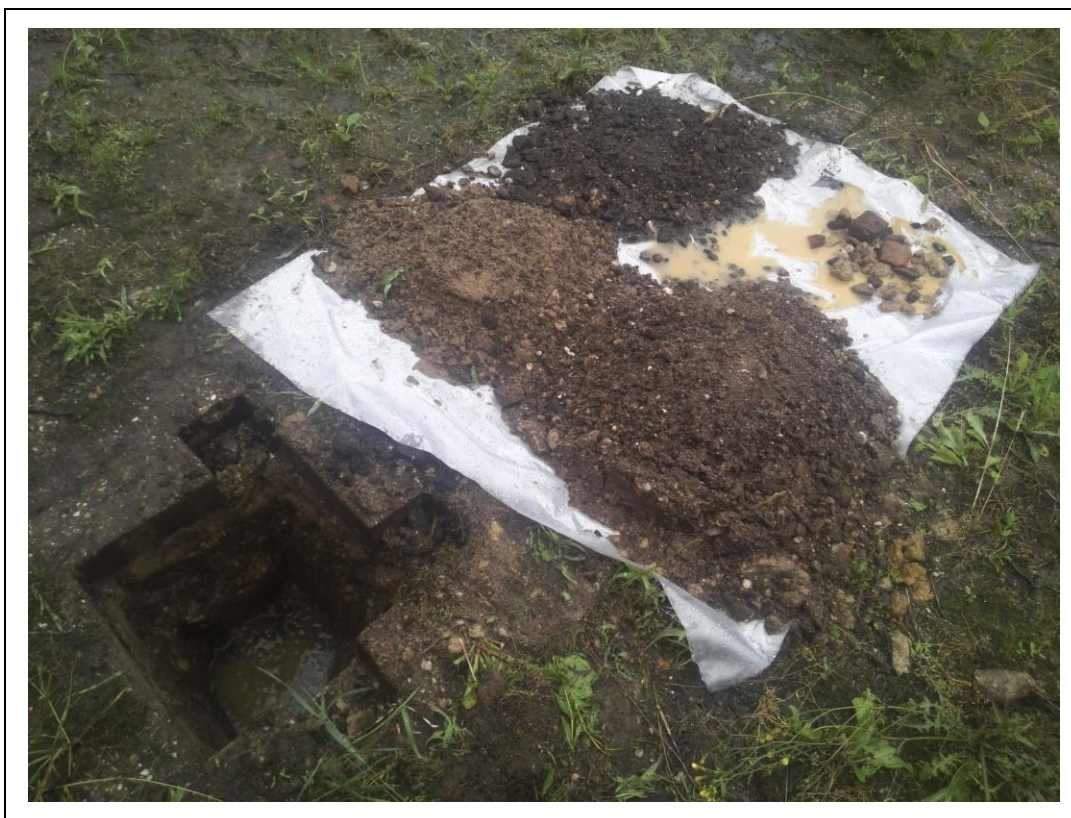
Foto 8. Asbestgat en opgegraven materiaal ASB-06
