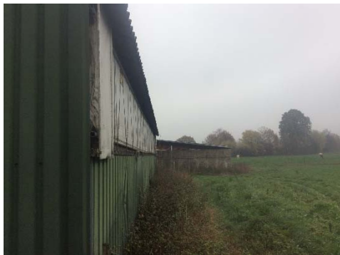
Figuur 8: Ontbreken van een dakgoot bij druppelzone
