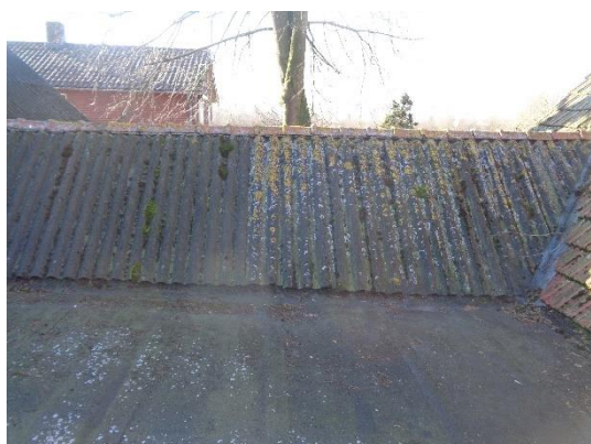
Gedeelte dak van aanbouw heeft golfplaten
