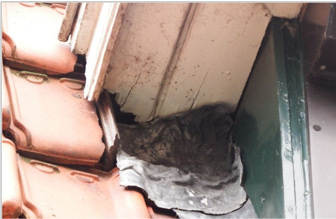
Detail van de onderzijde van de boeiborden bij de dakkapellen. Er zijn openingen aanwezig welke geschikt zijn als verblijfplaats voor huismus. Foto: | Ecoresult B.V.
