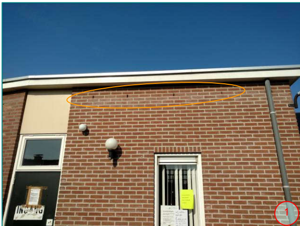
Foto 1: Enkele open stootvoegen als potentiële invlieg mogelijkheden voor vleermuizen. Alleen aanwezig in de voorgevel van het gebouw.
