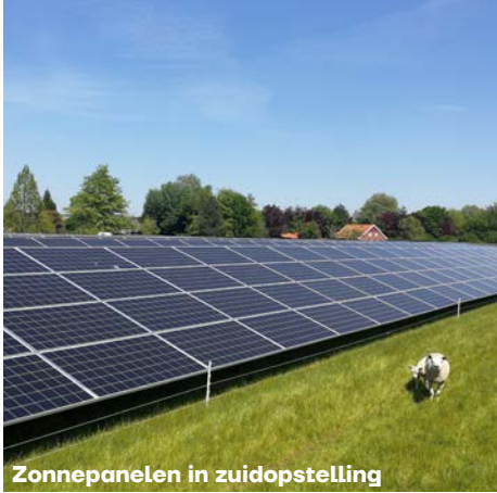
Zonnepanelen in zuidopstelling
