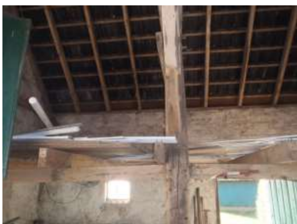
Foto 5: binnenzijde met gebint, niet beschoten kap. Boven de muur is de strook hardboard onder de eerste pan zichtbaar.
