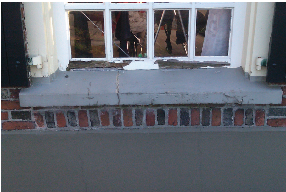
Foto 3: gescheurde raamdorpel in linker zijgevel
