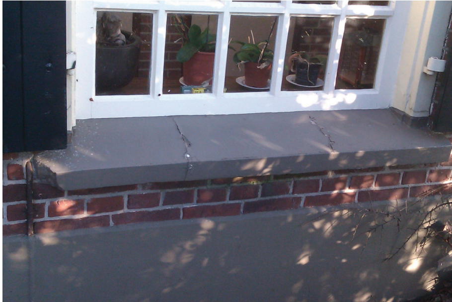
Foto 2: gescheurde raamdorpel in voorgevel
