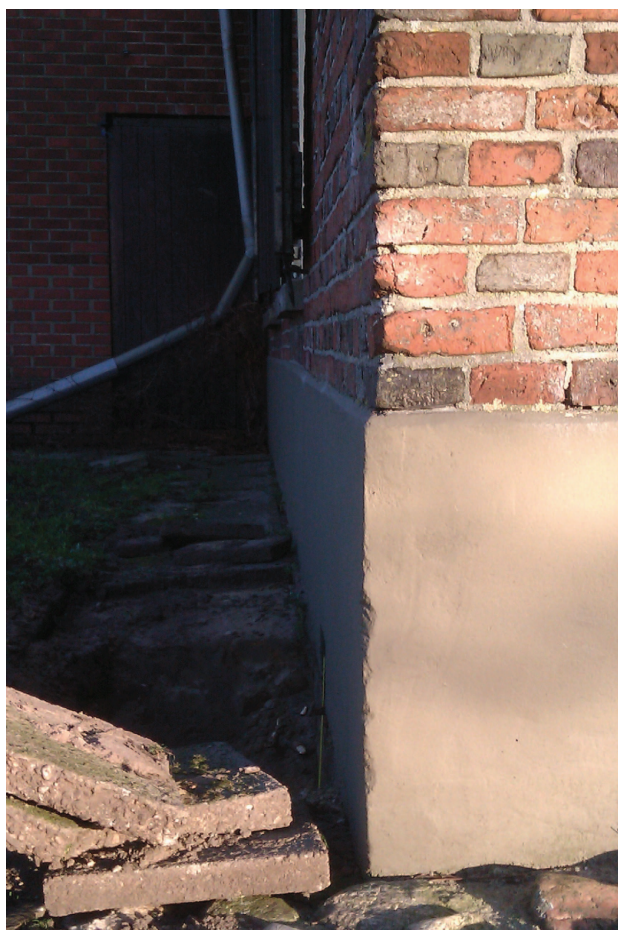
Foto 5: lintvoeg linker zijgevel
