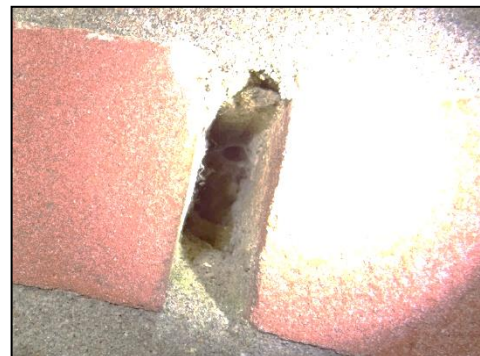
Figuur 11. Bij inspectie van de stootvoegen blijkt dat de spouwmuur volledig geïsoleerd is.
