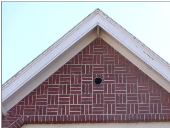
Foto 2. Detail voorzijde winkelpand Dijkstraat 16. Geschikte kieren, welke mogelijk toegang kunnen bieden tot ruimte tussen dak en dakbeschoot, ontbreken hier tussen de overstekende dakrand en de opgaande muur.
