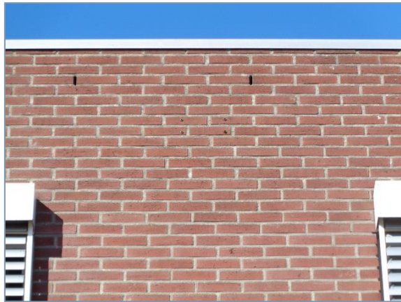
Foto 6. Detail rand bedrijfspand (zijde Koemstraat) met open stootvoegen.
