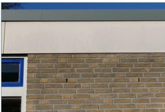
Foto 5. Open stootvoegen zuidgevel gymzaal.
