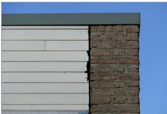
Foto 8. Ruimten tussen muur en gevelbekleding bij schoolgebouw.
