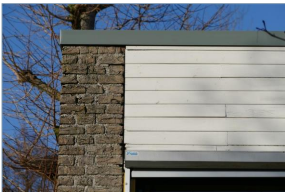
Foto 7. Ruimten tussen muur en gevelbekleding bij schoolgebouw.
