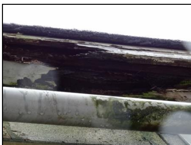
Figuur 13. Verrotte dakrand van gebouw 2.
