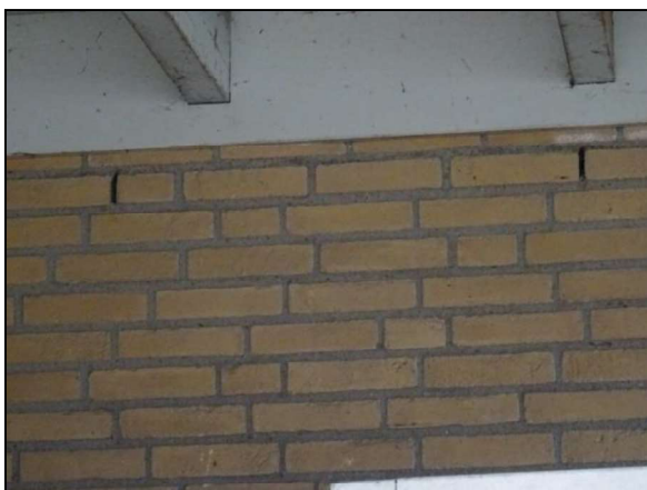
Figuur 13. Open stootvoegen geven toegang tot luchtsponw.
