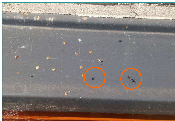
Foto 1: aangetroffen uitwerpselen van vleermuizen.
