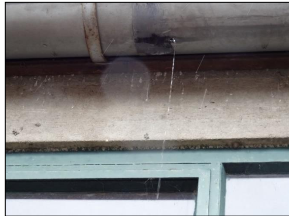
Figuur 10. Uitwerpselen onder dakgoot.
