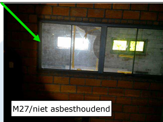
Foto 84 | Stopverf kozijn kantoor
