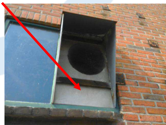
Foto 150 | Plaatje in ventilatiekoker zijgevel
