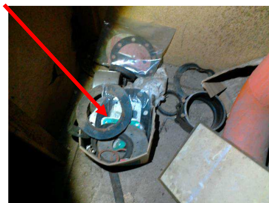
Foto 86 | Restanten flenspakkingen sprinklerruimte
