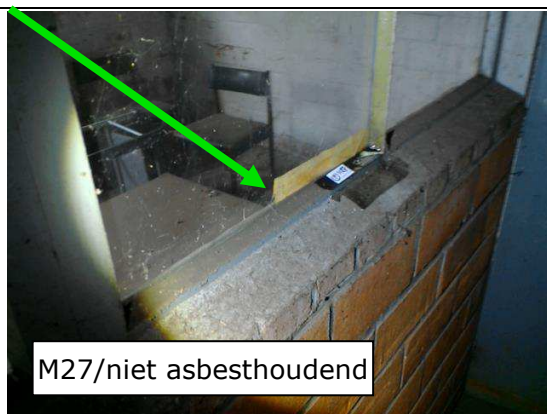
Foto 83 | Stopverf kozijn kantoor
