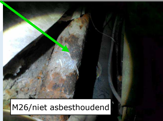
Foto 82 | Restanten isolatie op leiding
