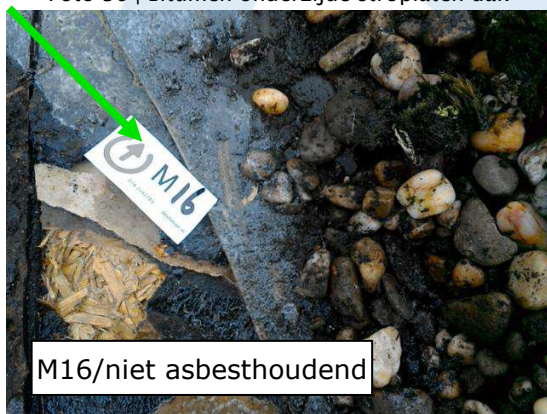
Foto 38 | Bitumen onderzijde stroplaten dak
