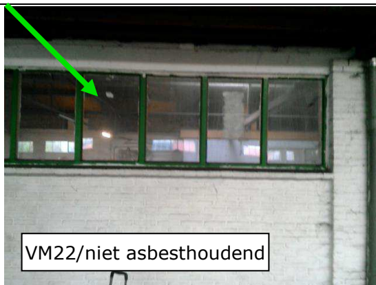
Foto 194 | Stopverf kozijn scheidingswand
