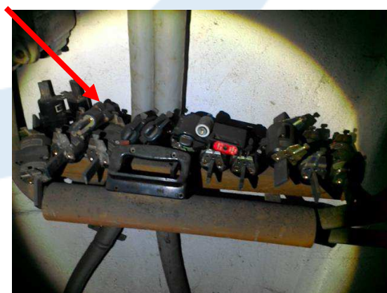
Foto 190 | Meszekeringen in magazijn
