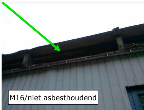
Foto 36 | Bitumen onderzijde stroplaten dak
