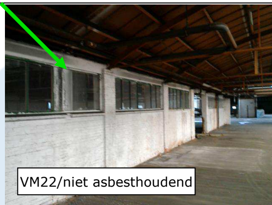
Foto 195 | Stopverf kozijn scheidingswand
