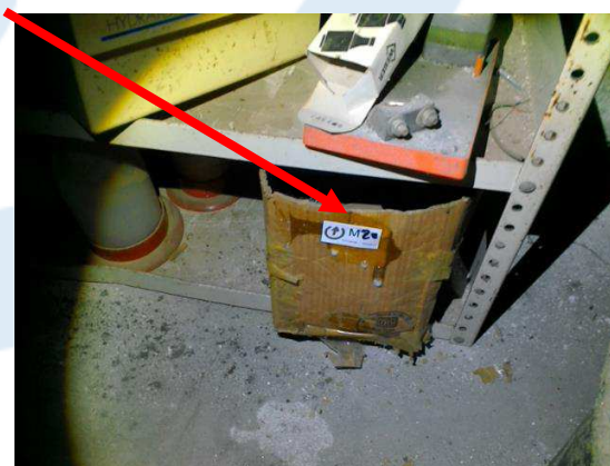
Foto 57 | Meszekeringen in magazijn
