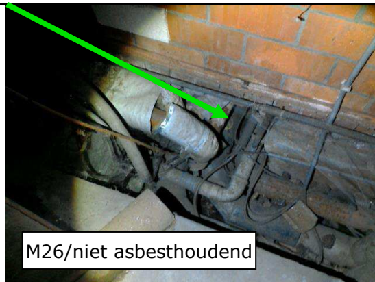
Foto 81 | Restanten isolatie op leiding
