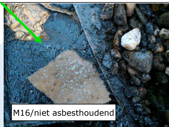
Foto 37 | Bitumen onderzijde stroplaten dak
