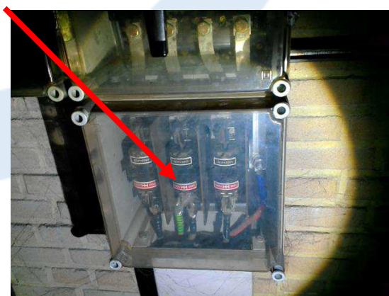
Foto 253 | Meszekeringen in hal
