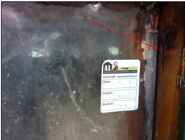
Foto 7: Schuur 1: Beglazingskit (M02AA & M03AA)
