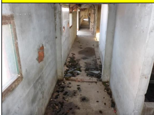
In schuur 1: Restanten golfplaten (M01AZ)
