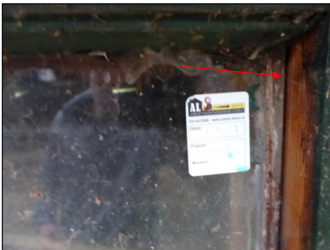
Foto 9: Schuur 1: Beglazingskit (M02AA & M03AA)
