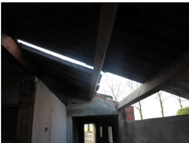
Foto 47: Schuur 1: Binnenzijde met stormschade
