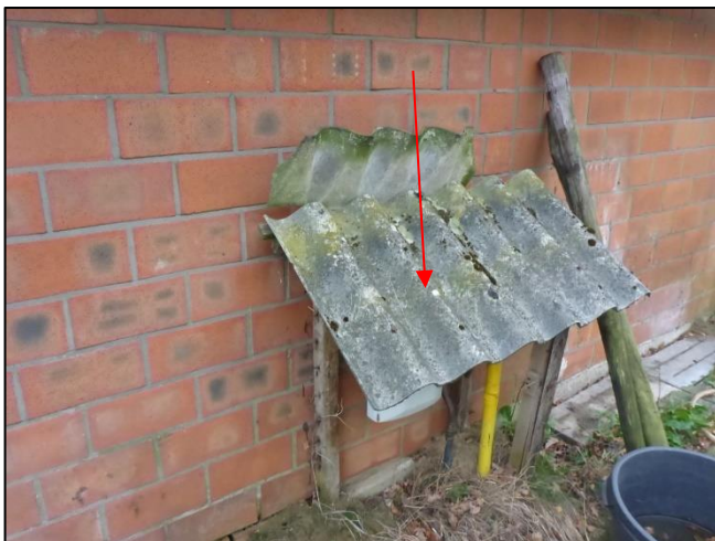
Foto 5: Afdak schuur 1: Golfplaat (M01AZ)
