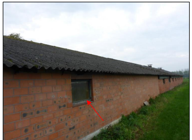
Foto 6: Schuur 1: Beglazingskit (M02AA & M03AA)
