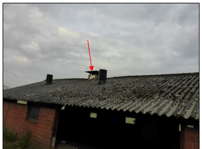
Foto 12: Schuur 1: Ventilatiekoker (M06AZ)
