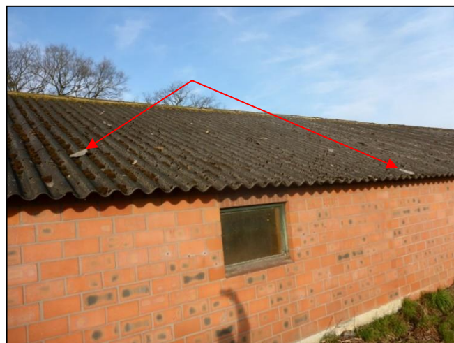
Foto 50: Op en naast schuur 1: Restanten golfplaten (M01AZ)
