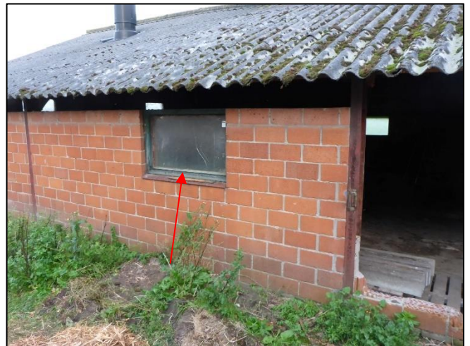
Foto 8: Schuur 1: Beglazingskit (M02AA & M03AA)
