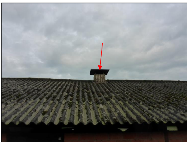
Foto 11: Schuur 1: Ventilatiekoker (M06AZ)
