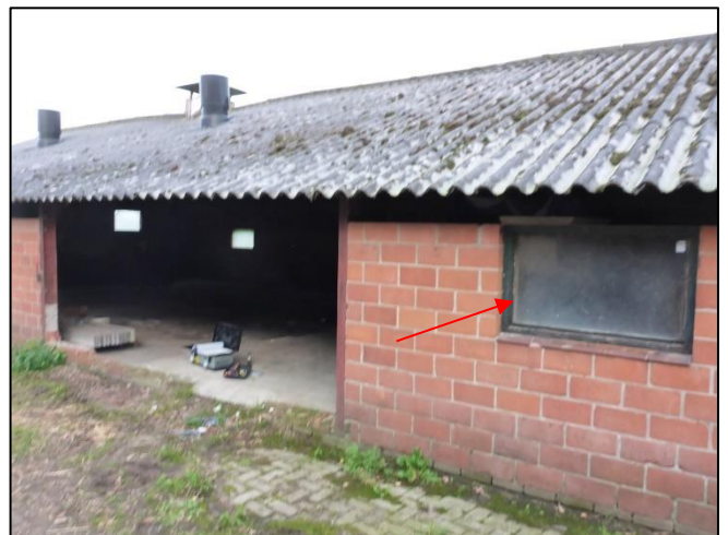
Foto 10: Schuur 1: Beglazingskit (M02AA & M03AA)
