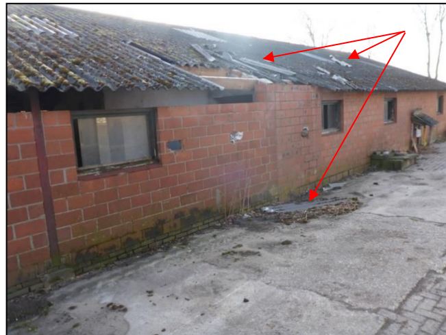
Foto 46: Op en naast schuur 1: Restanten golfplaten (M01AZ)
