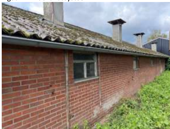
Figuur 14: Dakgoot bebouwing
