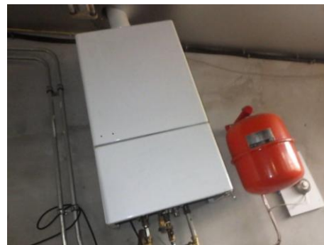
niet asbestverdachte CV Vaillant schuur 1
