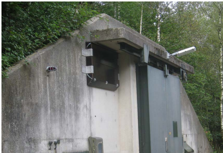
Afmeting kast: 1,80m breed, 1 meter hoog; deze is geplaatst op vliegbasis Soesterberg
