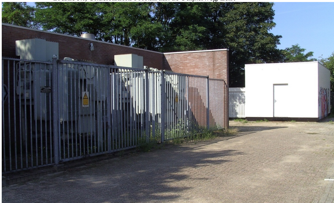
Locatie 3.6, Onderstations ProRail aan de Odijkerweg, Zeist
