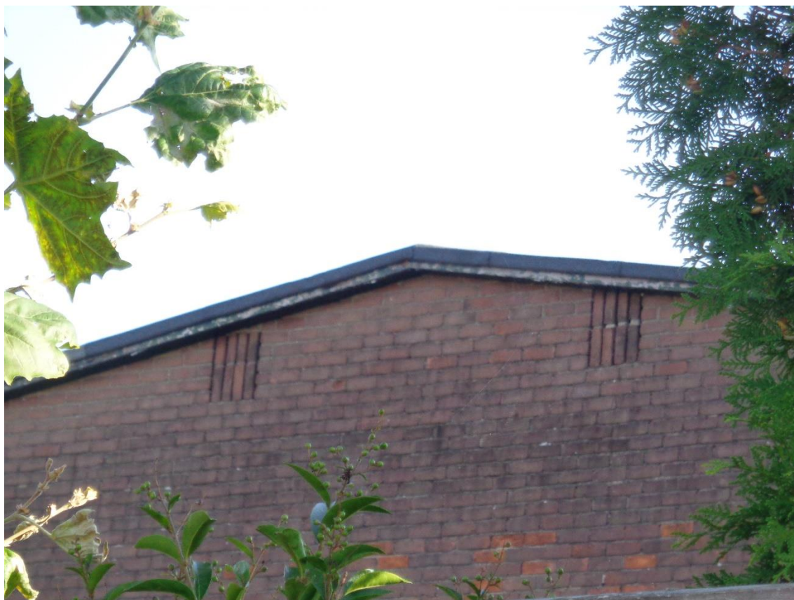
Figuur 9. Achterzijde van de stal met de open stootvoegen.
