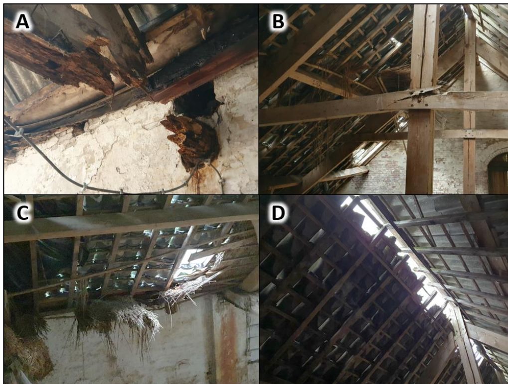
Figuur 3 De vervallen staat van schuur B fotografisch weergegeven. Lekkage door gaten in het dak (C/D) heeft steunbalken doorgerot (A) waardoor het volledige dak instabiel is geworden (B).
