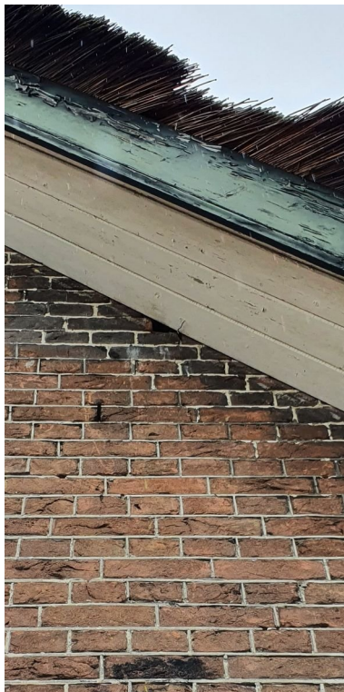
Aan de achterzijde van het achterdeel van de boerderij ontbreken stenen op de grens van de buitenmuur en de dakrand. : Ecoresult BV.
