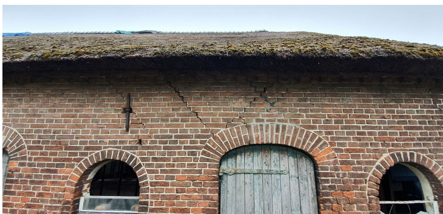
Op veel plaatsen in de boerderij en de monumentale schuur bevinden scheuren in bakstenen buitenmuren. | Ecoresult B.V.
