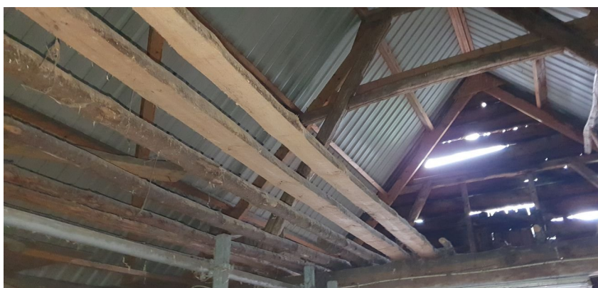
De binnenzijde van de veldschuur met veel gaten en kieren in de voorgevel. / Ecoresult B.V.
