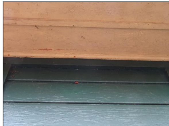
Figuur 18. Nauw aansluitende dakranden, betimmeringen waar vleermuizen achter kunnen verblijven ontbreken.
