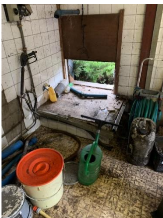
Figuur 9 foto van locatie aandrijfpomp
