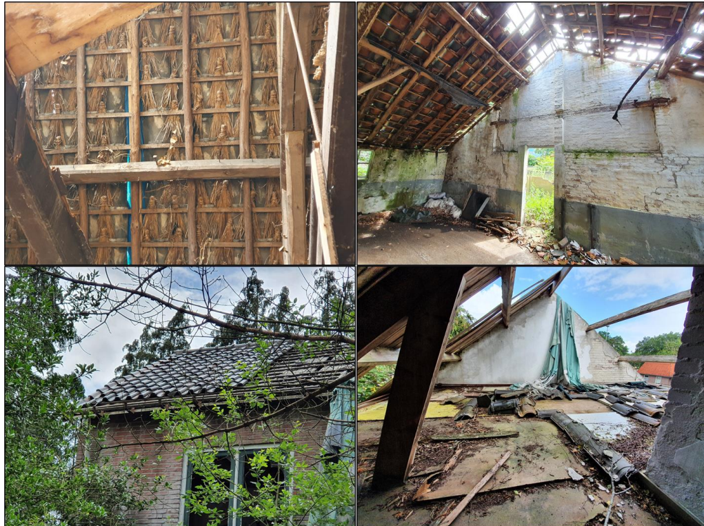
Figuur 5 Aan de binnenzijdes van de daken ontbreekt het aan dakbeschot (boven). Bij delen van het dak die intact zijn gebleven is sprake van een tochtstroming en mogelijke het inregenen tijdens regenbuien (linksonder). In sommige delen van de bebouwing ontbreekt zelfs het gehele dak (rechtsonder).
