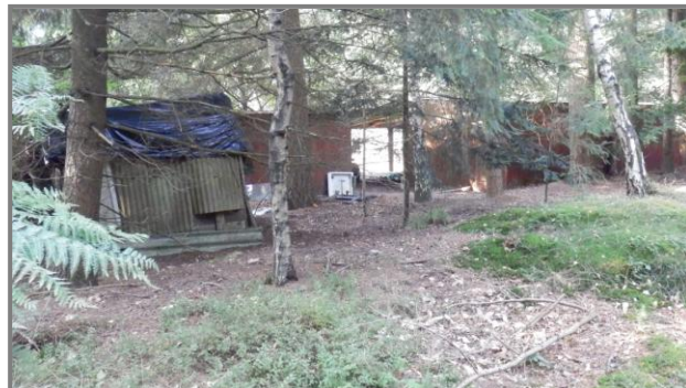
Aanbouwtjes met asbest golfplaten
