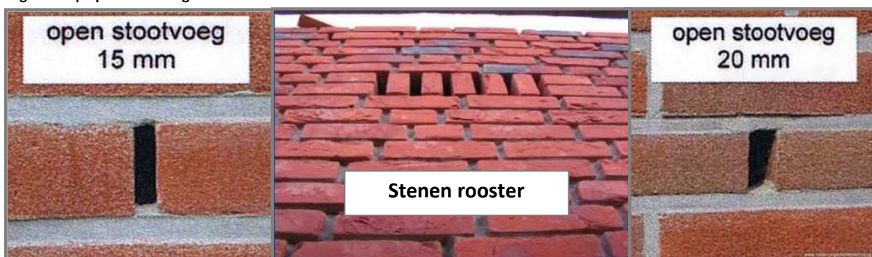
Figuur 8 | Open stootvoegen en een stenen rooster.
