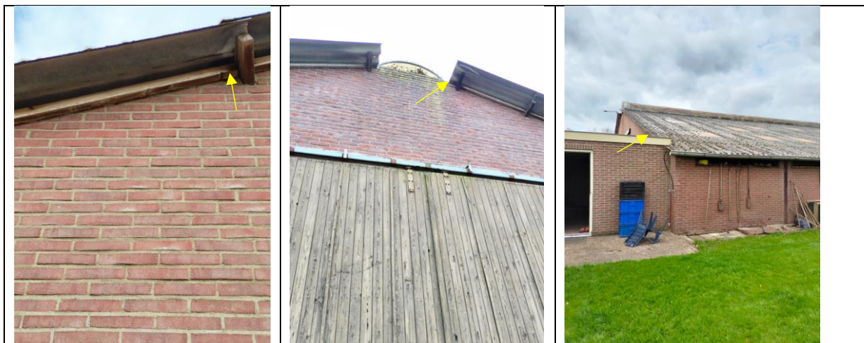
Figuur 7.5 Diverse openingen welke mogelijk toegang bieden tot in de bebouwing voor vleermuizen.
