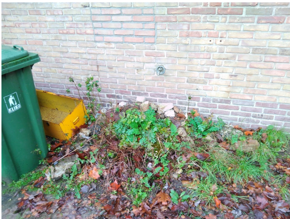
Foto 3: depot bouw en sloopafval tegen achtergevel gebouw C
