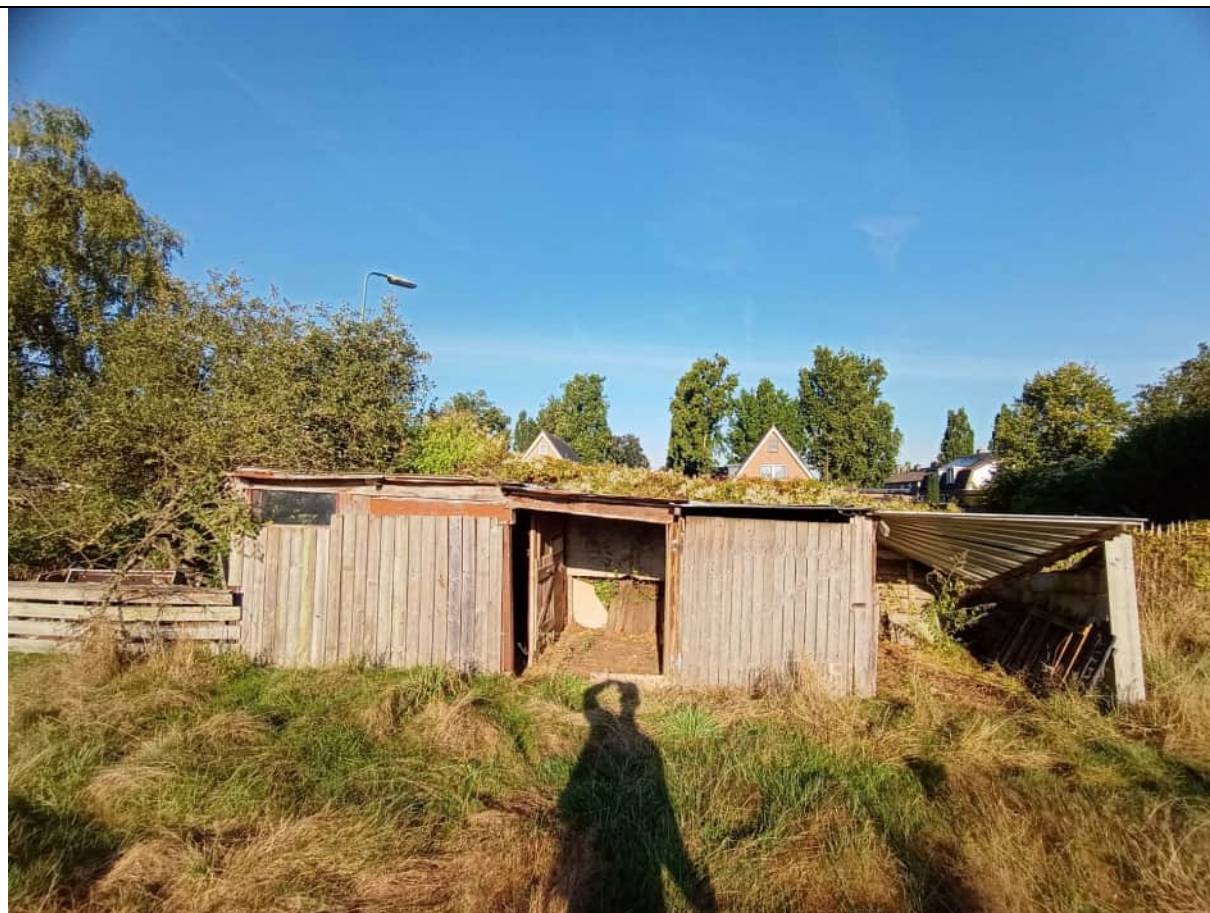
Schuur met asbestverdacht materiaal
