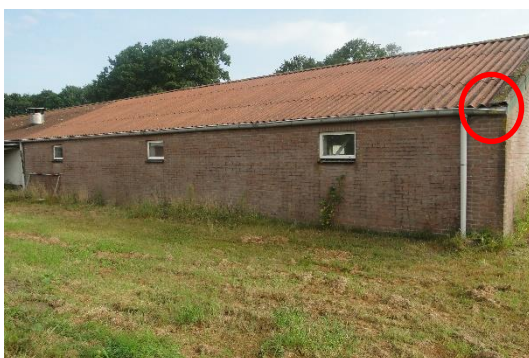
Figuur 4.3 Gat (rood omcirkeld) tussen de dakrand en de muur bij de middelste stal.
