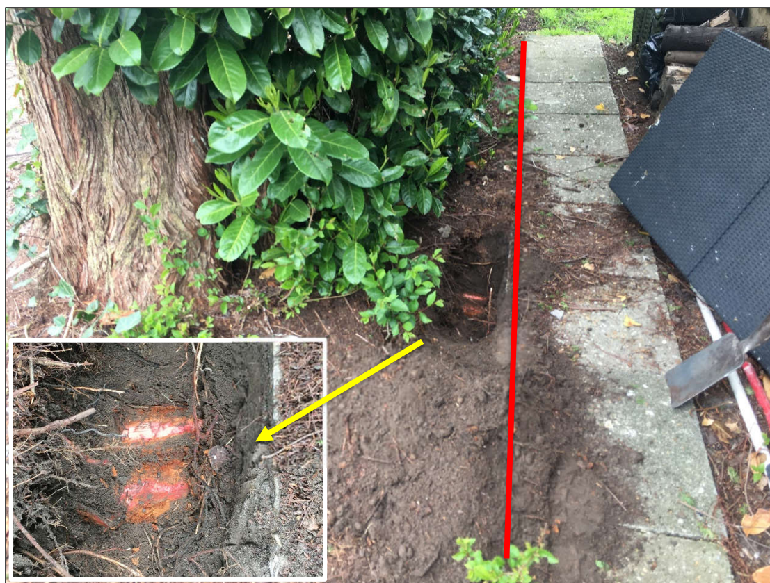
Afbeelding 8: Stabiliteitswortels boom 3 ter hoogte van de nieuwe tuinmuur (rood);
